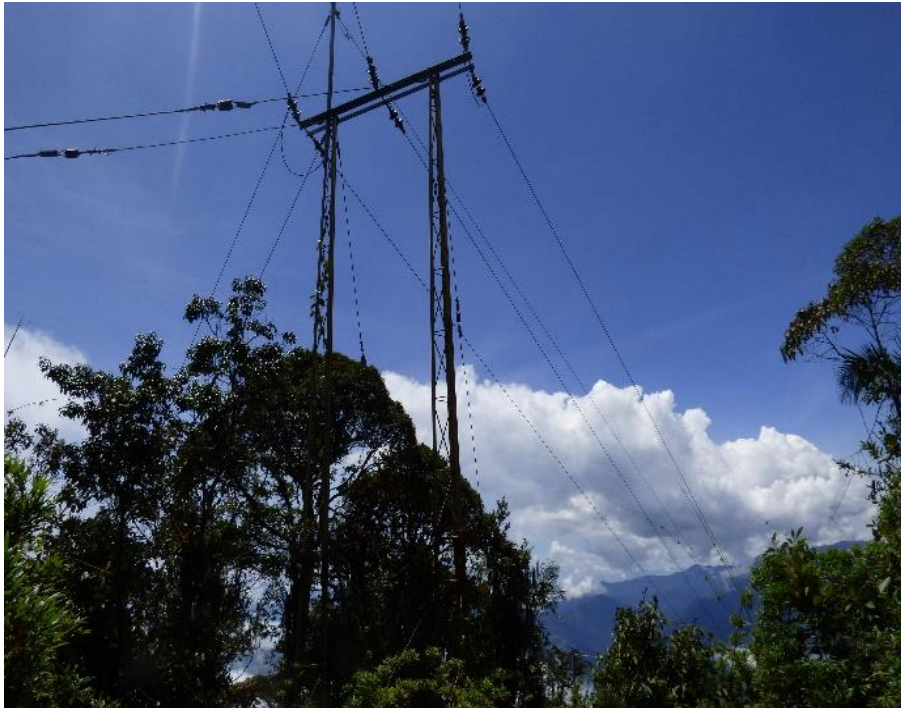
Figura 9. Torre tipo H
