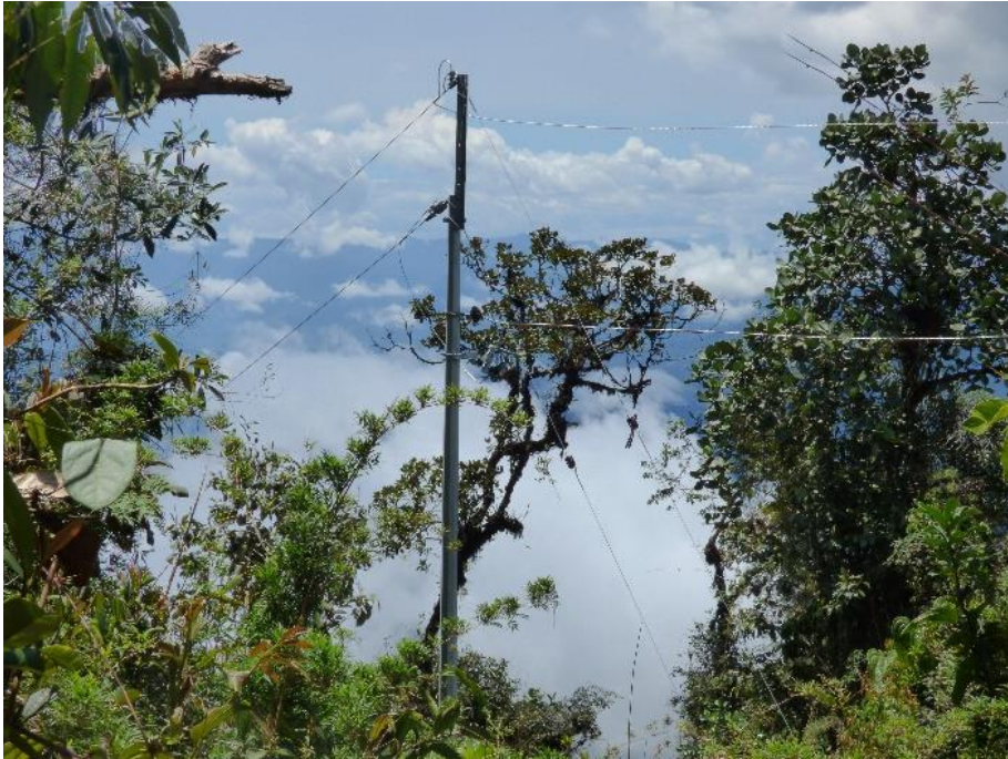
Figura 11. Poste de metal
