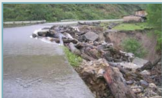
Fig. 18. Pérdida de capa asfáltica por diseño y mantenimiento inadecuados en ruta Jaén - Moyobamba.
