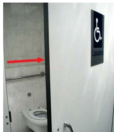
Foto 18: Puerta en baño accesible, que abre hacia fuera.
