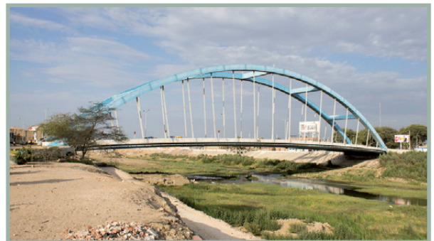
Puente Bolognesi reconstruido después del FEN 1997-1998, departamento de Piura.
