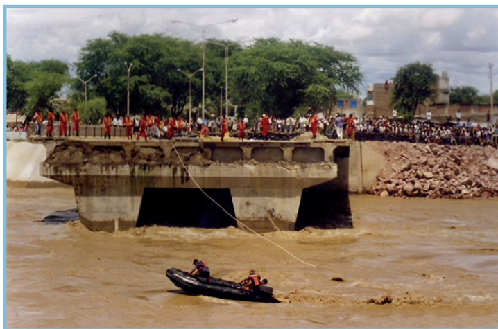
El puente Bolognesi impactado por el fuerte caudal y material de arrastre lo que generó su colapso, es decir, un desastre, Piura (FEN 1997-1998). [Fotografía: Diario El Tiempo, Piura]
