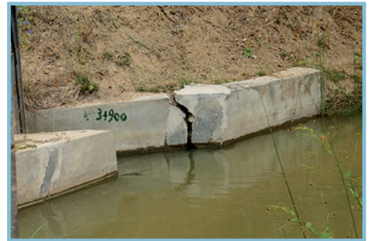
Canal de riego en condiciones de fragilidad y expuesto a probables deslizamientos.
