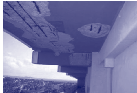
Acero expuesto por pérdida de recubrimiento.
