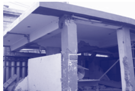
Daño severo en unión viga-columna.
