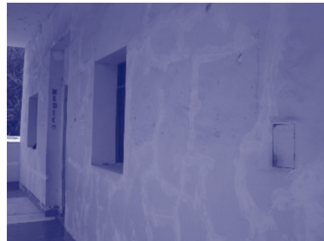
Pasado un evento adverso, en la restauración de las instalaciones de salud afectadas, muchas veces los daños estructurales son ocultos.
