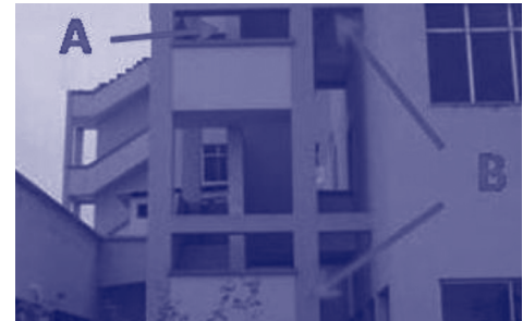
La escalera de emergencia de un hospital (A), fue “anclada” a la estructura de su edificio principal (B), originando -en un sismo- posible efecto de torsión.
