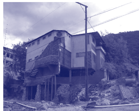
Evidencia de inseguridad en los elementos de soporte del edificio.
