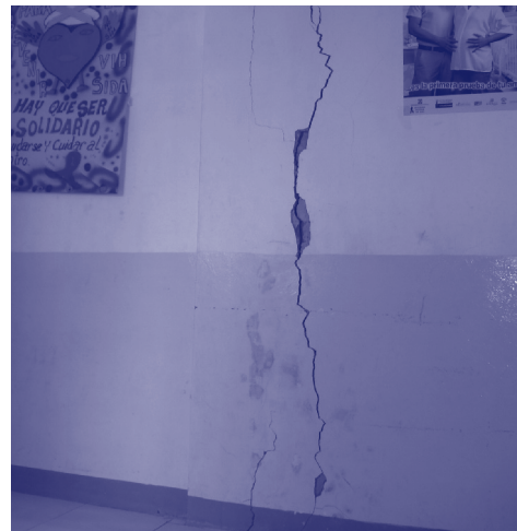
Grieta en un muro portante que rompe las piezas de mampostería.
