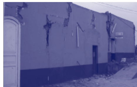
Típica falla en construcciones de tierra.
