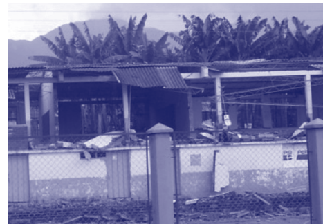
Estructura metálica que falló ante un sismo.
