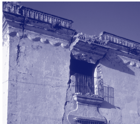
Cuando el suelo se expande por presencia de humedad, puede provocar rajaduras en pisos y muros.
