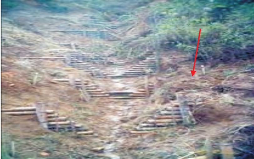
Disipadores usados en quebradas, en forma de trincheras.
