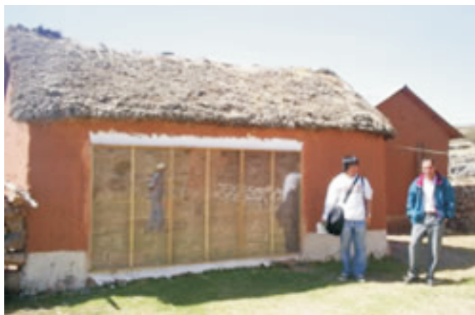
Muro trombe vertical instalado en una vivienda de adobe, uno de los seis prototipos experimentales que SENCICO construyó Ilave - Puno
