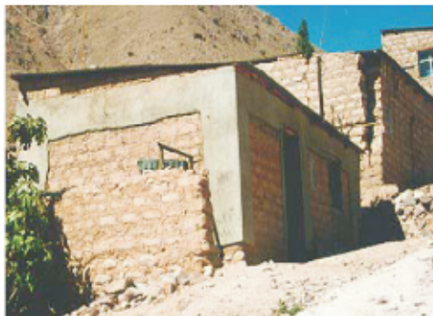
Efectos del sismo en Viviendas reforzadas
