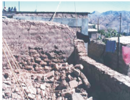
Efectos del sismo en viviendas sin reforzar
